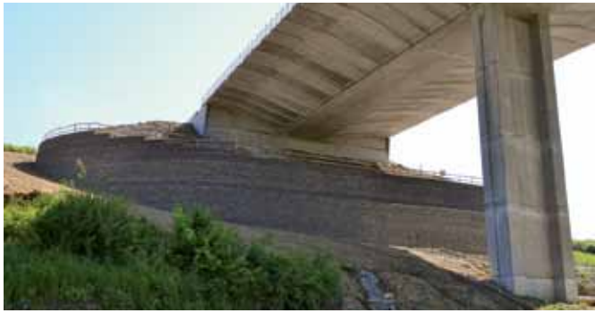
Obr. 7 Opora č. 5 mostného objektu 202-00 tvorená oporným múrom Terramesh na D1 Fričovce – Svinia
