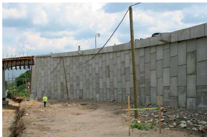
Obr. 8 Oporu mosta tvoria tri železobetónové rebrá, priestor medzi nimi je takisto vyplnený vystuženou zemínou.
