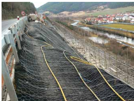
Obr. 2 Pohľad na realizáciu z koruny svahu so zachytením pomocnej konštrukcie na realizáciu klinkcov a kotiev
