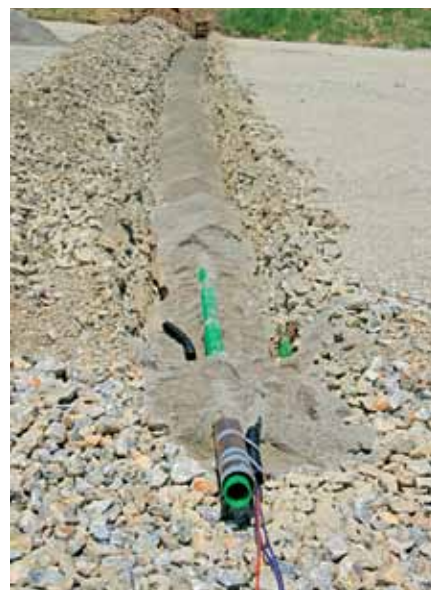
Inštalácia horizontálneho inklinometra
