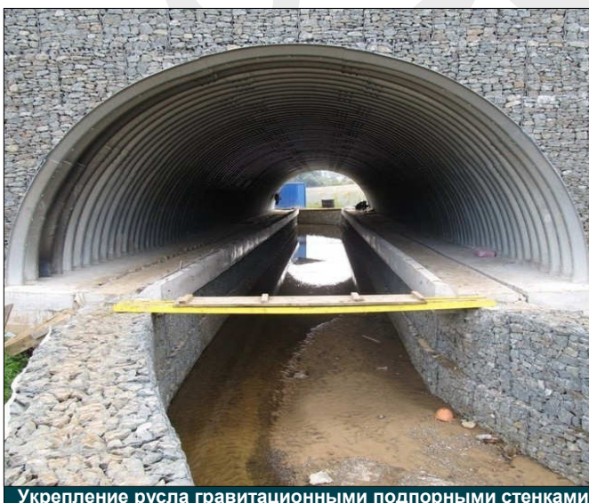
Укрепление русла гравитационными подпорными стенками
