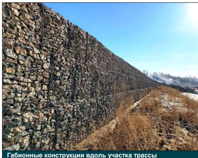
Габионные конструкции вдоль участка трассы
