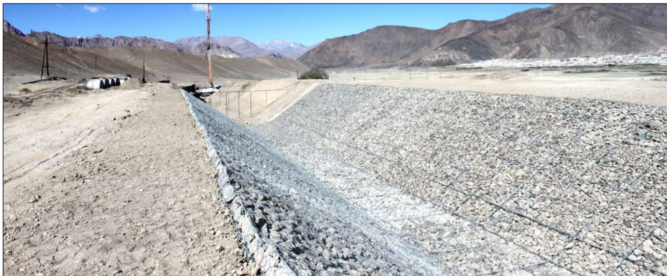
Укрепленный с помощью матрацев Рено деривационный канал гидроэлектростанции «Аксу»
