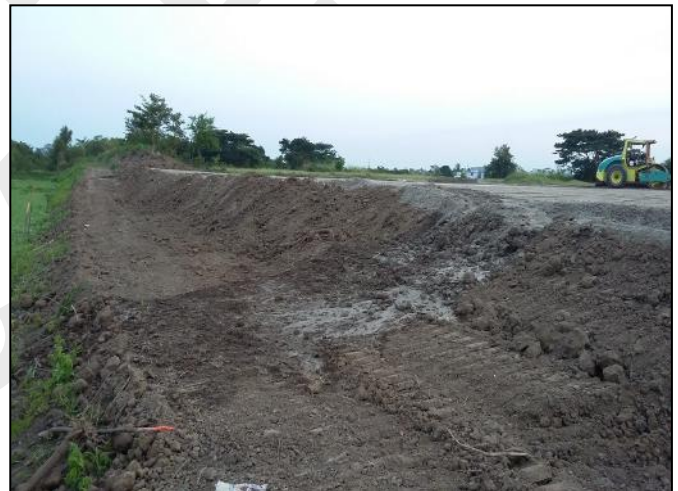
Fig 3. Canal con problemas de erosión
