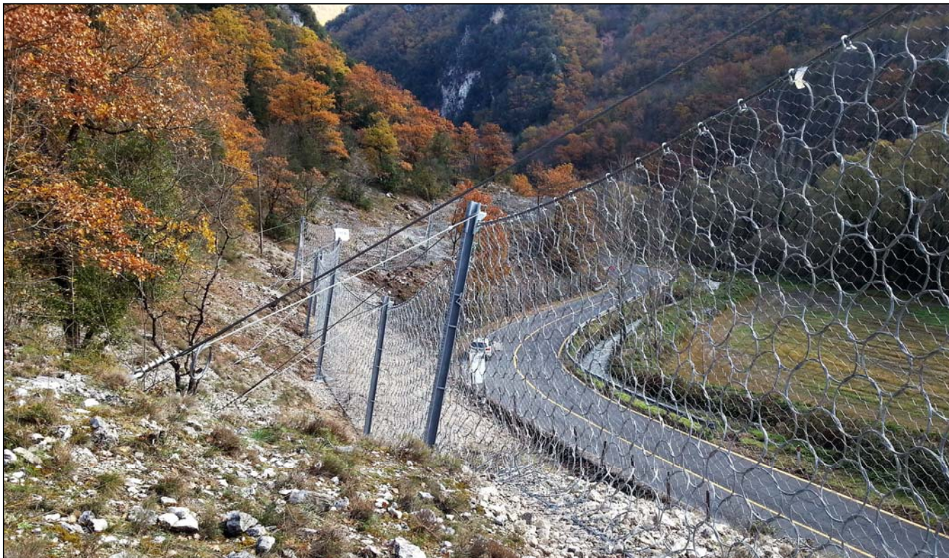
Vista delle barriere paramassi da 2000 kJ installate
