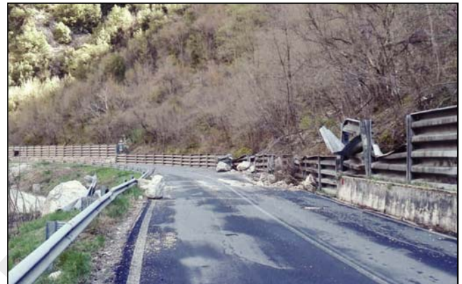
Massi caduti sulla carreggiata stradale (fonte: elaborati del progetto esecutivo di Anas)
